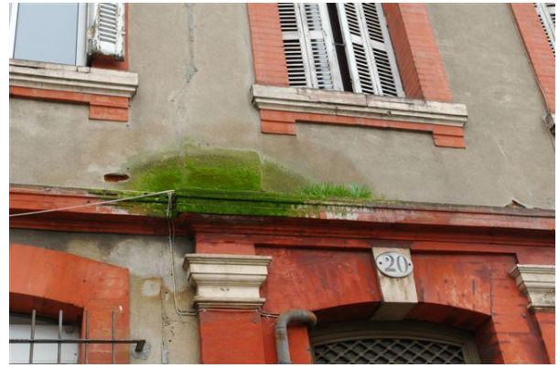
Une gouttière qui fuit, les algues s'installent
